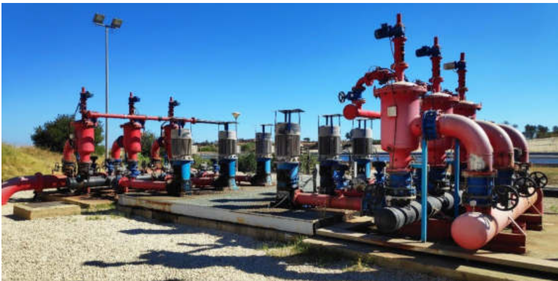
Fotografía nº 1.- Equipos de la Estación y Filtrado de la Comunidad de Regantes.
