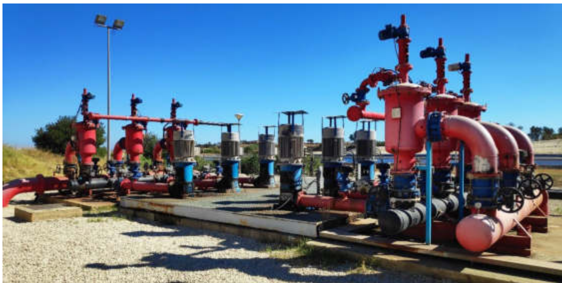
Ilustración nº 2.- Equipos de la Estación y Filtrado de la Comunidad de Regantes.
